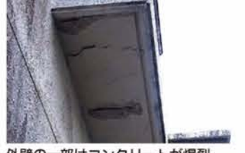
外壁の一部はコンクリートが爆裂
