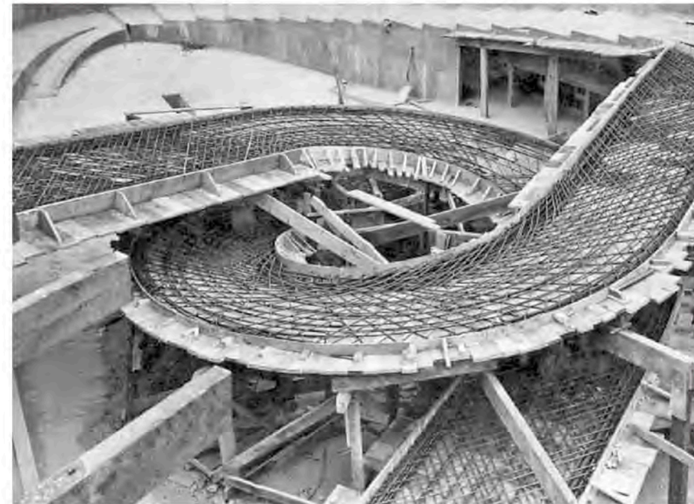
ペンギンプールスロープの配筋状況。スラブ厚は外側が90mm厚、内側が150mm厚。(写真提供 ロンドン動物園)
