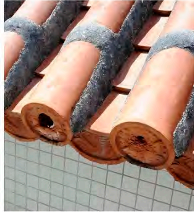
沖縄県平和祈念資料館 屋根の赤瓦の腐食。粘土内の鉄分がさび、雨があたりにくい鼻部は塩分が雨で洗い流されないため、腐食し穴があいた。建物は海岸崖部にあって日常的に多量の海塩が吹き付ける。
