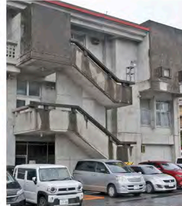
浦添市内公共建物 外壁が塗装やタイルなどで被覆されておらず、コンクリート打放し仕上げのため屋根や庇のない部分の外壁は水が浸透して濡れる。
