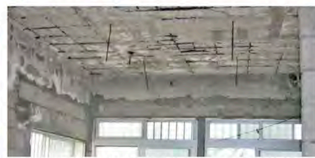
上/沖縄では凍結がないため防水されていない屋上が多い。防水されている場合でも塗り防水程度。経年劣化により雨水がスラブに浸透する。下/防水されていない住宅の屋上スラブ下が爆裂した状態。
