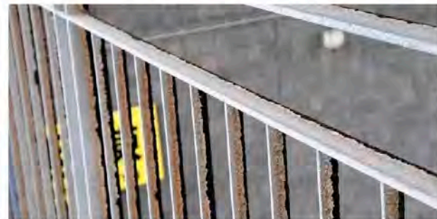
沖縄県総合福祉センター 上/大屋根鉄骨の腐食 下/手すりの腐食。両者とも付着量500g/m 2 の亜鉛どぶ漬け部材だが「雨がかり」でないため、付着した塩分が雨で洗い流されず、手すりは風方向の腐食が激しい。
