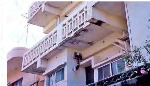
上：防水がされていないため爆裂した屋根スラブ下。 下：外壁塗装の維持管理不備によって爆裂した外壁。
